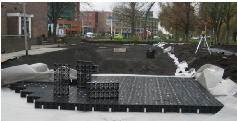
Foto 5 Aanleg van infiltratiekratten onder de Emmastraat in Gouda. Infiltratiekratten houden tijdelijk water vast na een extreme regenbui. Water kan later infiltreren in de bodem.
